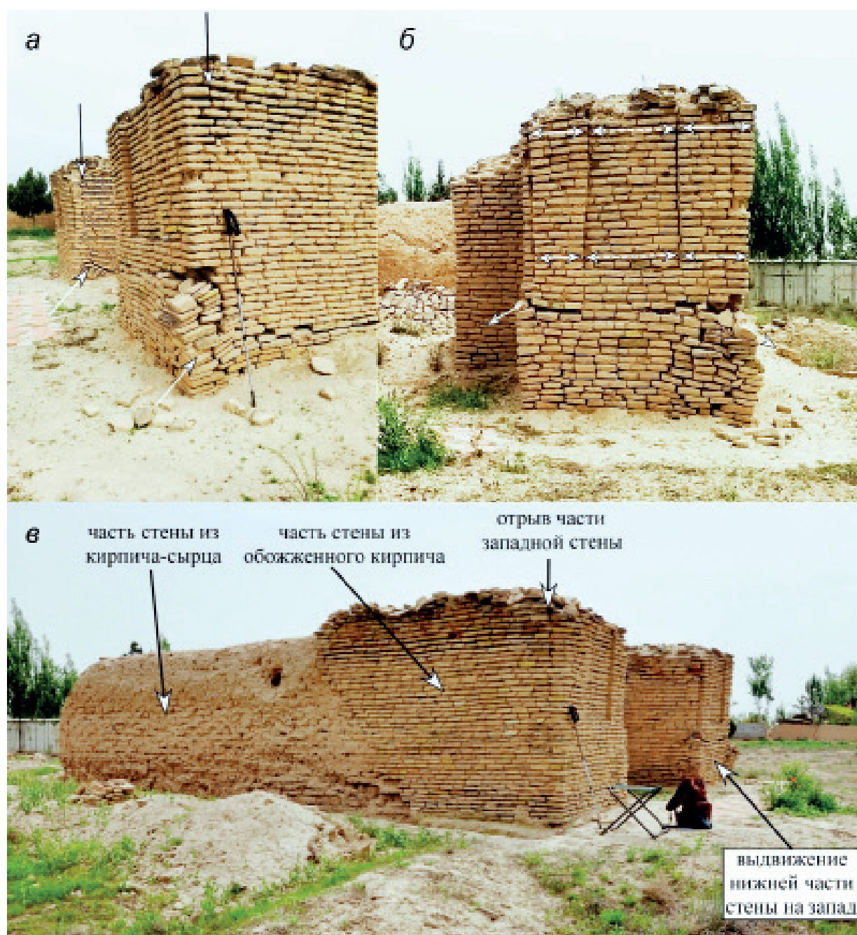
Рис. 6. Исследование средневекового надмогильного сооружения — Мавзолея Абдуллы Сурени: а — западные окончания крыльев Сурени. Белые стрелки показывают выдвижение, наклон и выпадение угловых частей сооружения, черные стрелки — отход, отслаивание западных фасов обоих крыльев от смежных стен при землетрясении; б — вид на западную стенку южного крыла Сурени. Двухсторонние прерывистые стрелки указывают разную ширину ложного окна в верхней и нижней его частях. Двухсторонние стрелки — изменение ширины простенков на север и юг от окна. Односторонние стрелки — направления выдвижения, наклона и выпадения угловых частей крыла сооружения; в — общий вид сооружения (на юг-юго-восток)
