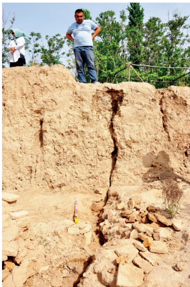
Рис. 5. Раскрытая трещина в грунте, в которую попадали кирпичи с шатающегося минарета (его восточная часть видна слева). При раскопках кирпичи были вынуты из трещины и положены на восток (справа) от нее
